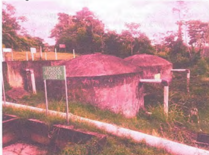
Fotografía: PLANTA DE TRATAMIENTO EXISTENTE
