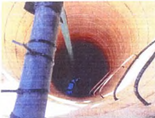
Pozo de Captación.
