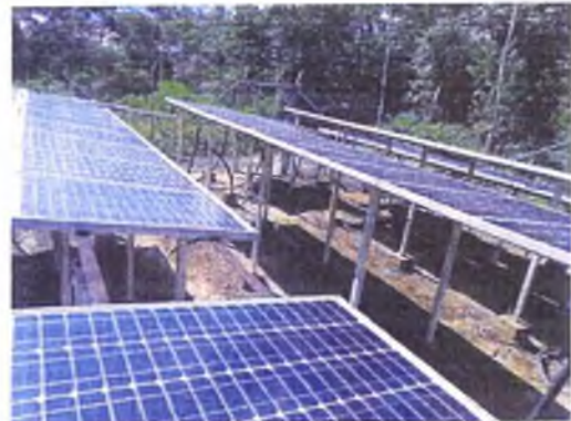
Paneles solares fotovoltaicos.
