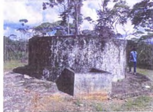
Tanque de Reserva
